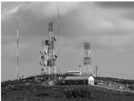
Figura 1. Estação Rádio Base
